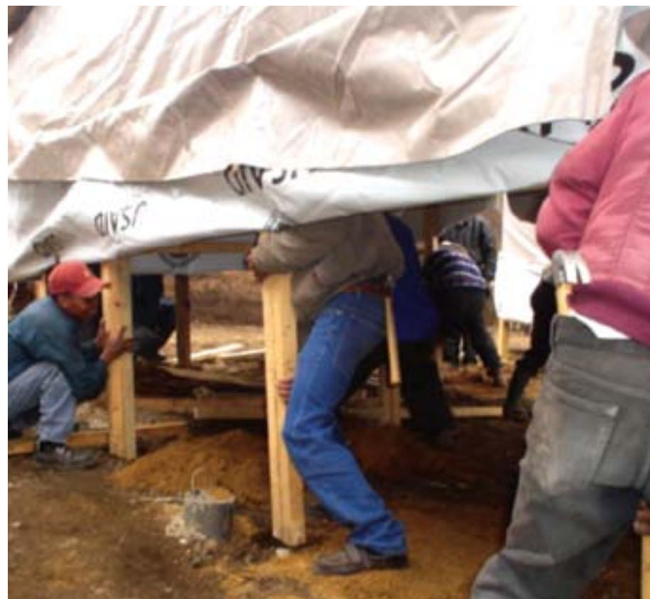
Imagen No. 15 Solución en campo para reducir la vulnerabilidad ante el fuerte viento. ATU Stan. 2006. Fuente: SCEP.
