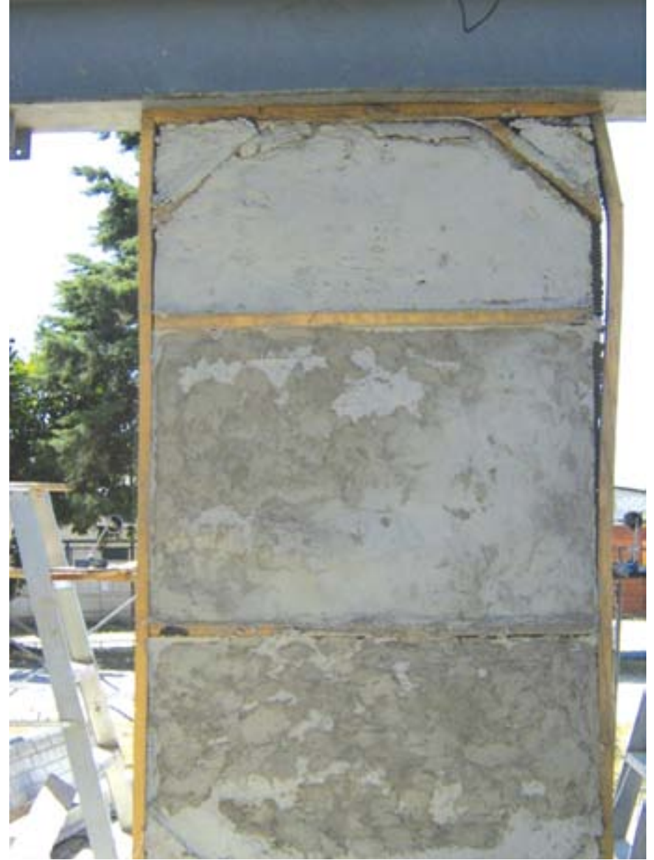
Imagen No.13 Panel en deformación al exceder carga máxima. Fuente: INDIS.
